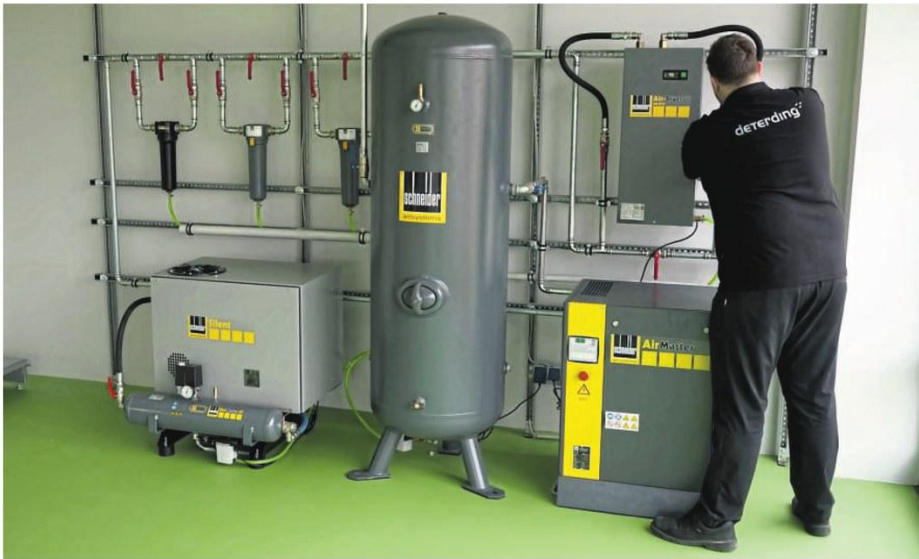
Im neuen Showroom werden die individuellen Projekte, wie hier die Kompressoranlage, ausgestellt.
